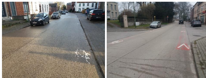
Photos 34 & 35 : bande cyclable suggérée cachée sous les voitures en stationnement d'un côté et s'effaçant de l'autre, rue de Priesmont à Marbais, et prolongation des marquages au droit du carrefour, dans cette même rue
