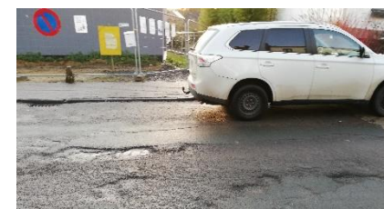
Photo 76 : Etat de la voirie devant l'entrée de l'école de Tilly
